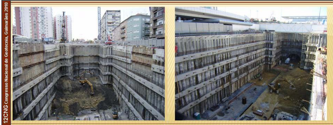
Figura 1 – Vistas das Escavações das Estações de Moscavide (à esquerda) e do Aeroporto (à direita)
