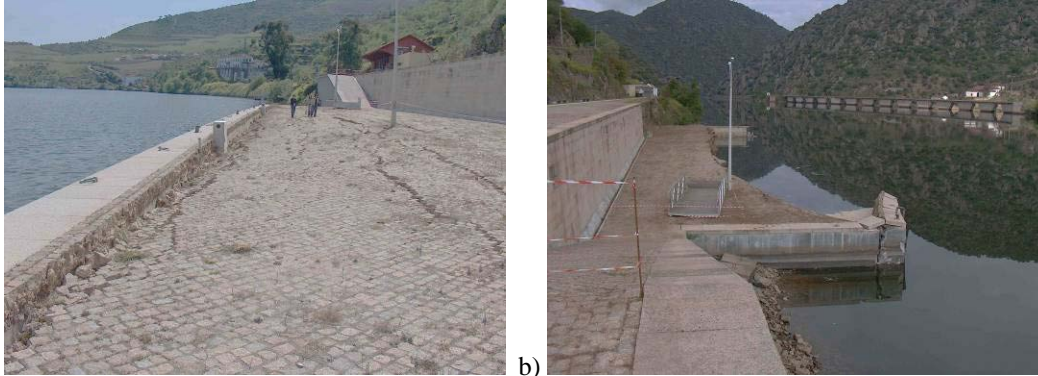
Figura 3 - Vistas do Cais da Ferradosa: a) Uma Semana Antes da Rotura; b) Após a Rotura
