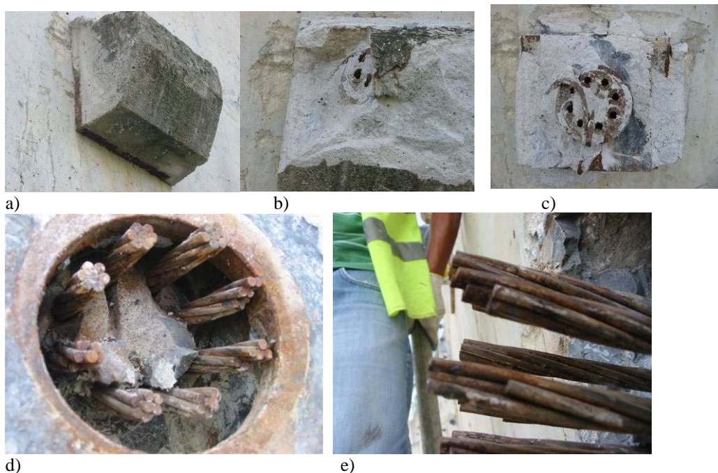
Figura 11 – Observação da Cabeça das Ancoragens Existentes e Ainda Seladas com Betão
