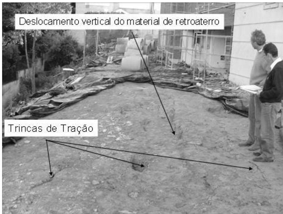
Figura 2 - Detalhe da região instabilizada
