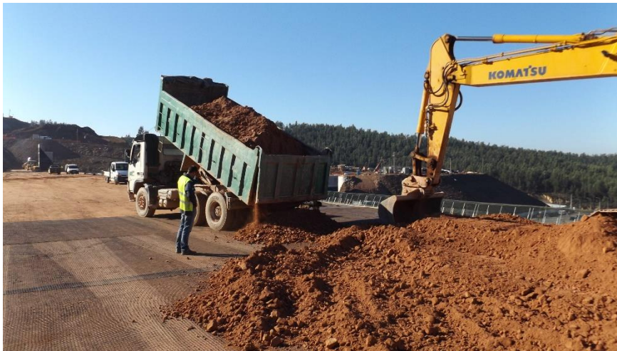
Figura 4 – Ejemplo efecto Daños Mecánicos sobre Geomalla
