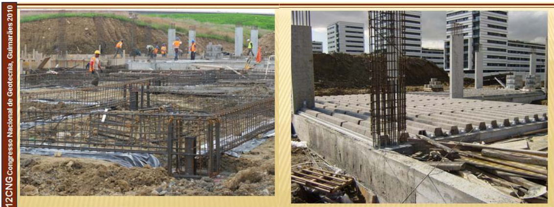
Figura 4 - Execução dos Maciços e Vigas de Fundação e da Laje do Piso Térreo
