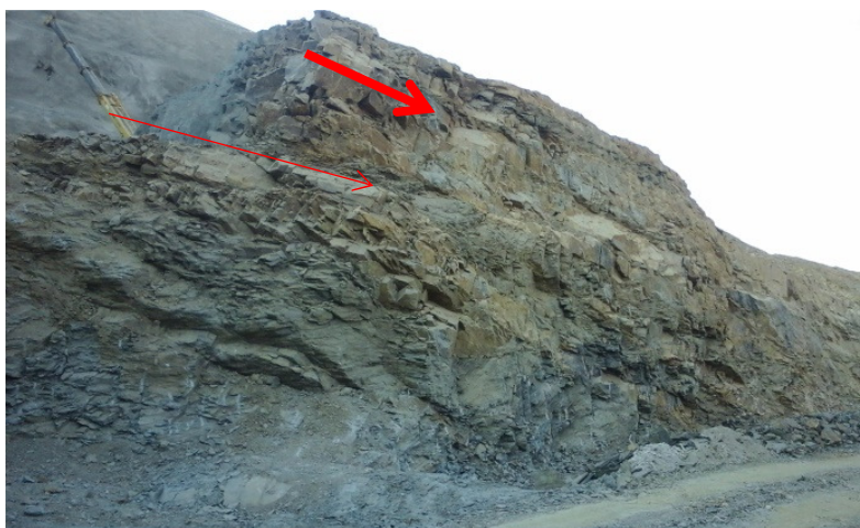
Figura 5A – Esporádicas roturas por toppling (seta vermelha grossa) acima da descontinuidade principal - Talude da Casa de Força
