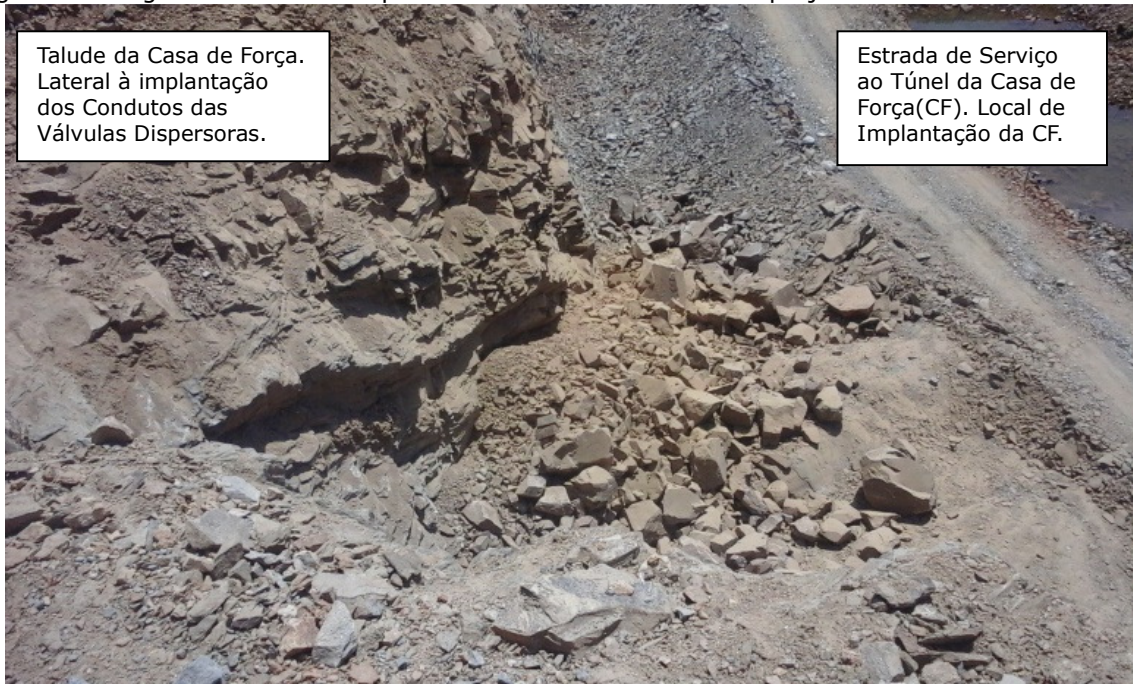
Figura 3 - Blocos soltos removidos após a detonação para a abertura da entrada dos condutos para as válvulas dispensoras. Lateral a Casa de Força
