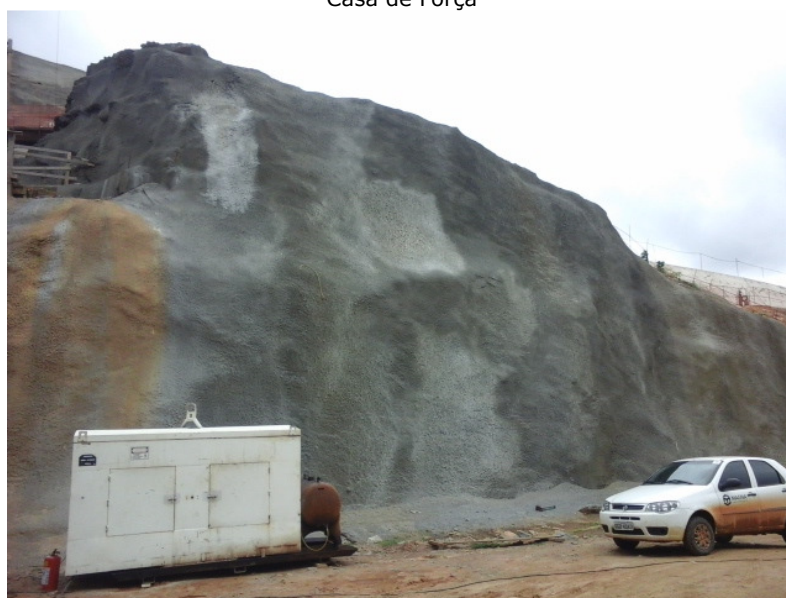
Figura 5B – Talude da Casa de Força após o tratamento com ancoragens e concreto projetado
