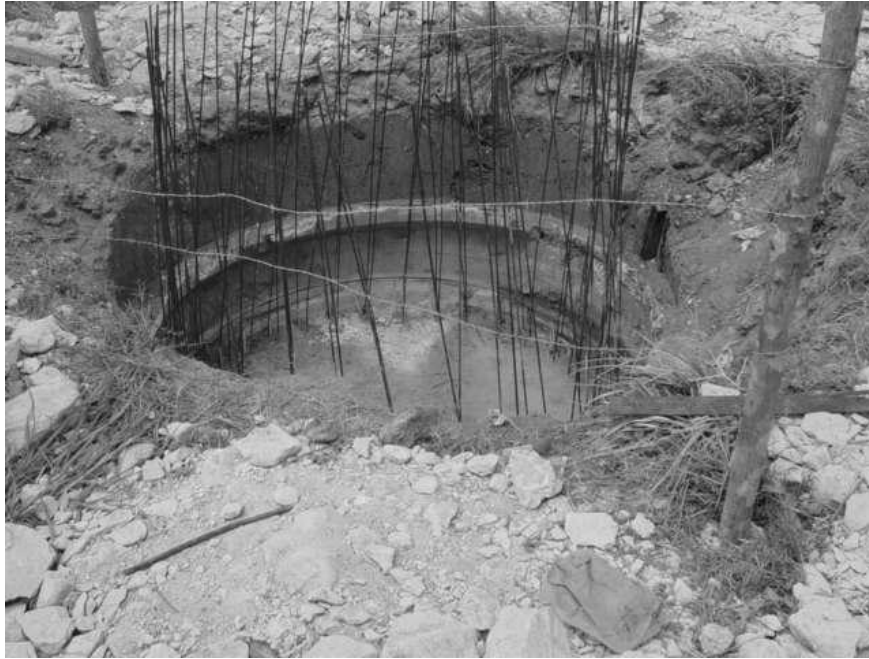
Figura 4 – Fundação de poste deteriorada
