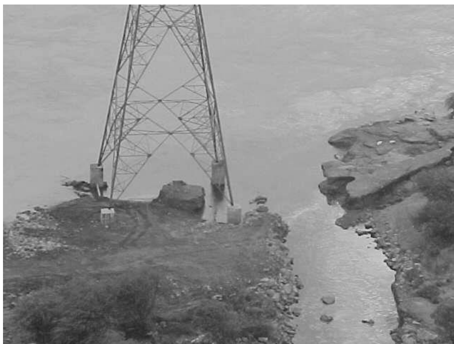
Figura 3 – Destruição do aterro e cintas de amarração
