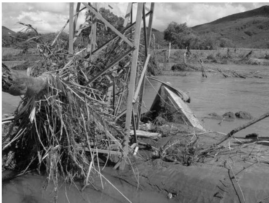
Figura 2 – Tombamento da fundação
