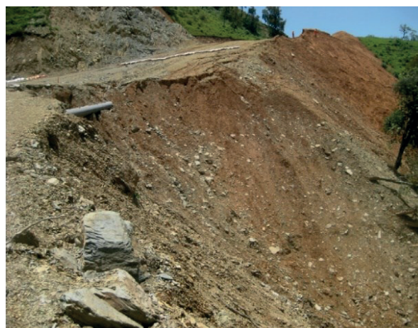
Figura 4. Oleoducto Zoquital – Catalina, Km 2+720. Deslizamiento rotacional y erosión regresiva.
