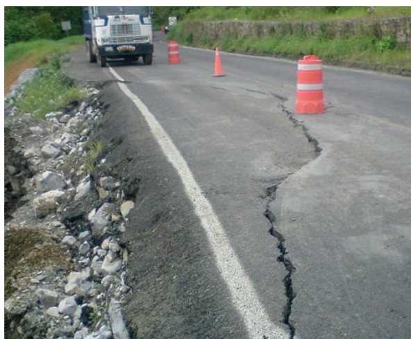
Figura 2. Carretera Pachuca – Tuxpan, km 105+200. Se observan fisuras en cabeza del deslizamiento.
