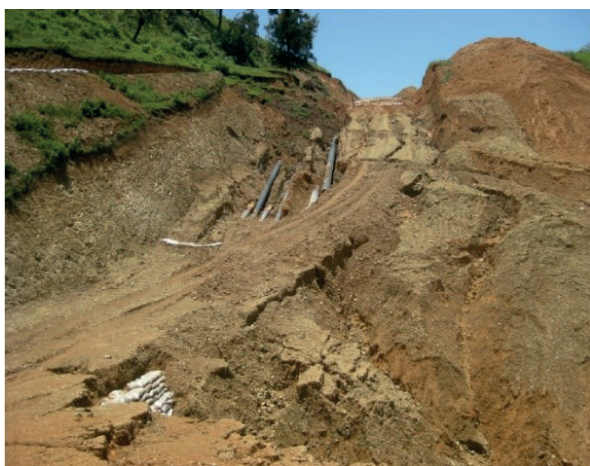
Figura 6. Oleoducto Zoquital – Catalina, Km 2+600.
