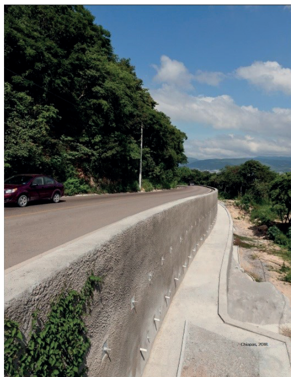
Figura 1. Estabilización mediante Sistema Estatec en dos niveles, en áreas montañosas de Chiapas (México).
