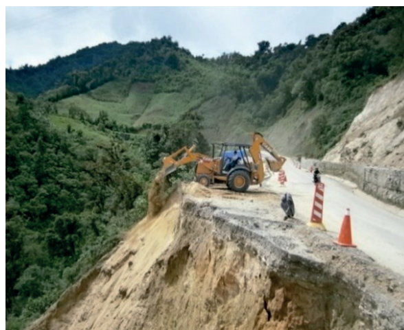
Figura 8. Deslizamiento en Km 46+130 Carretera Huixtla – Motozintla.
