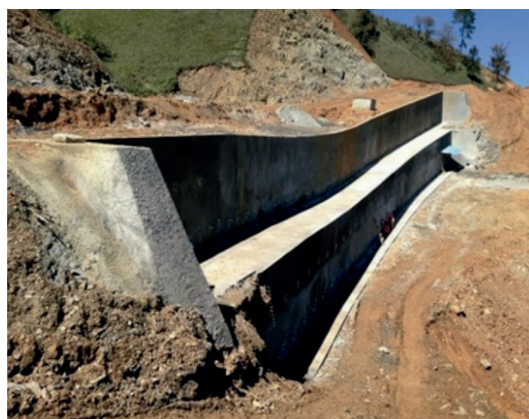
Figura 5. Oleoducto Zoquital – Catalina, Km 2+720.
