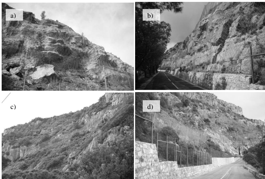
Figura 4 – (a) e (b) Redes pregadas e reforçadas com painéis de cabos de aço; (c) e (d) Barreiras dinâmicas de protecção contra a queda de blocos
