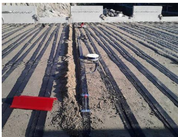
Figura 7 – Crackmeters instalados na cinta de reforço do muro e protecções do sensor.
