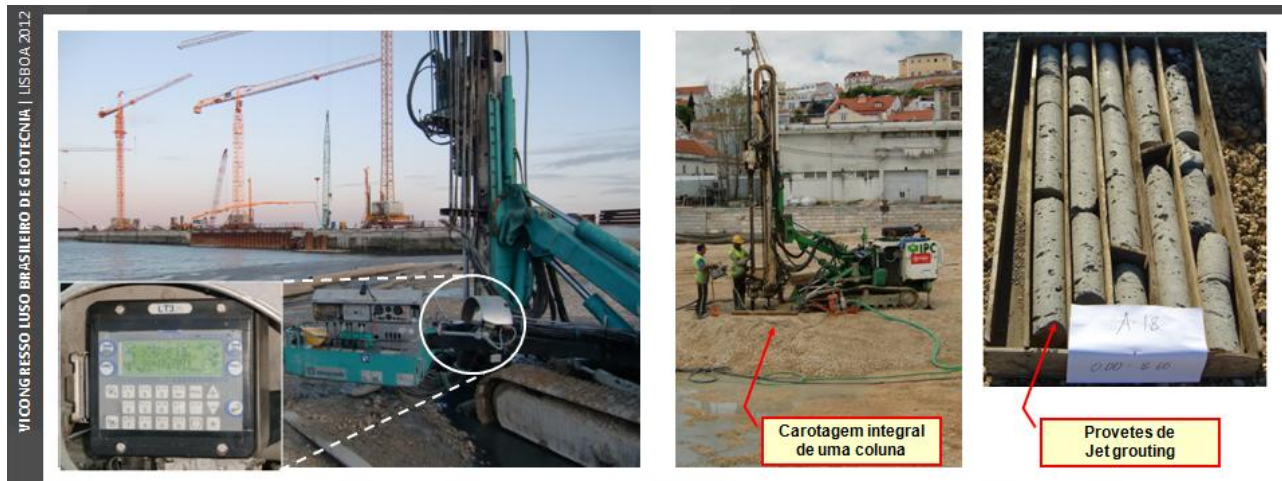
Figura 10 – Painel de Controlo do Equipamento de Execução das Colunas, Execução de Carotes e Caixa de Provetes
