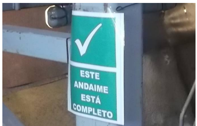
Foto 14 - Colapso de estruturas provisórias
