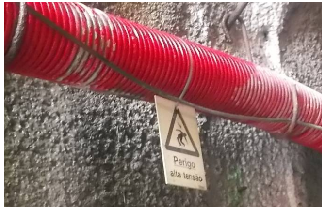
Foto 9 - Eletrização e eletrocussão
