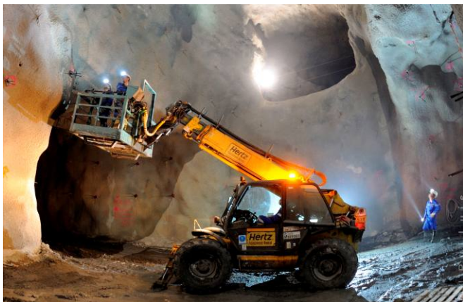
Foto 16 - Quedas ao mesmo nível/em altura
