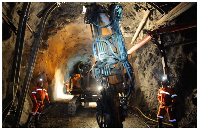
Foto 15 - Queda de material da frente de escavação ou de torrões de betão projetado
