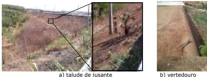
Figura 3 – Anomalias excepcionais na baragem Forquilha: a) linha de transmissão no talude de jusante; b) aterramento do canal de aproximação do vertedouro.
