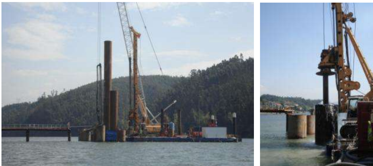
Figura 8 – Limpeza com Jet Water Air Lift e Furação com Balde e Vara Kelly
