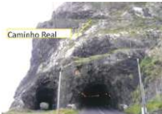
Emboquilhamento oeste do túnel Fajã da Areia, adjacente a um pequeno túnel pedonal já existente Western portal of Fajã da Areia tunnel, adjoining an already existing small pedestrian tunnel
