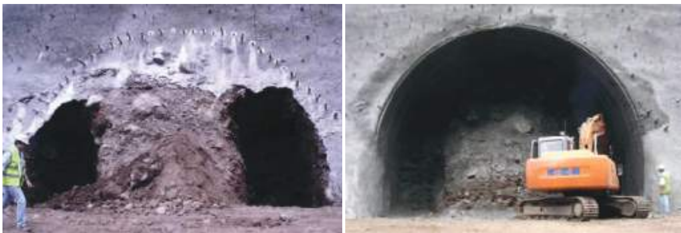
Fig. 04 Aspeto geral da frente de escavação do emboquilhamento de saída do túnel 1. À esquerda previamente à colocação de cambotas e à direita após colocação das primeiras cambotas. General view of the excavation of the exit portal of tunnel 1. On the left, before rib placement; and on the right, after rib placement.
