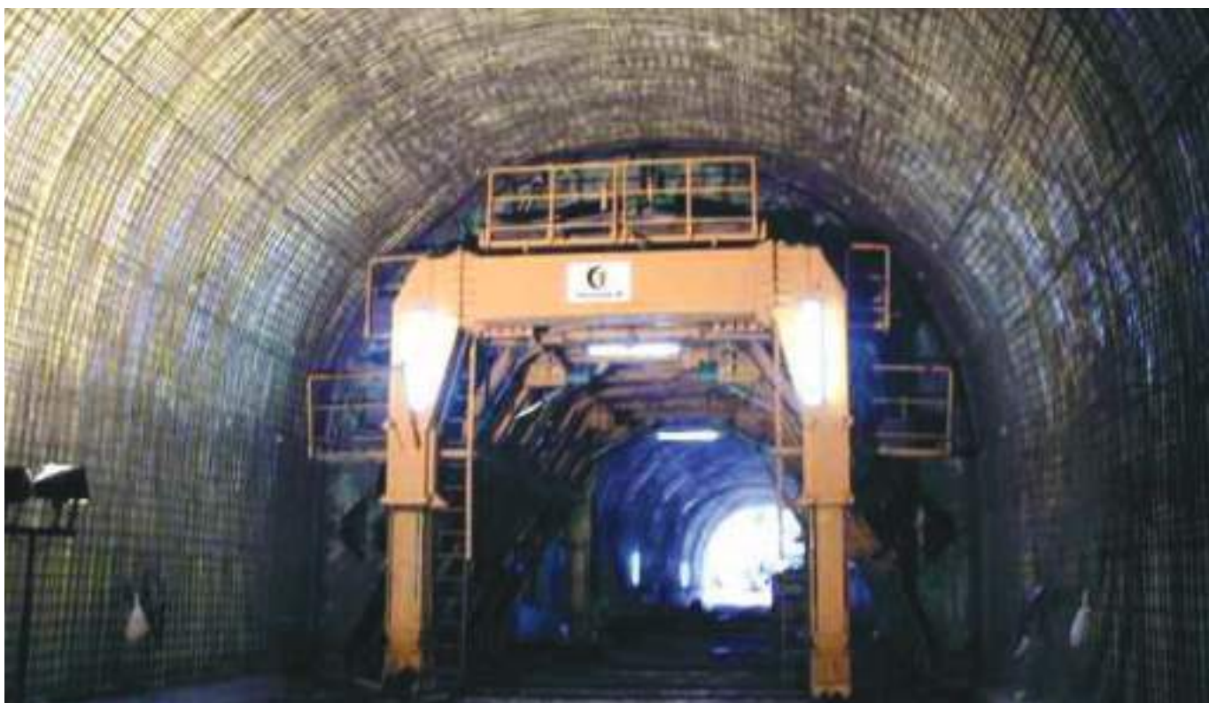
Fig. 06 Secção dos túneis correntes unidireccionais observando-se as armaduras e a estrutura de apoio à colocação da geomembrana de impermeabilização (túnel duplo do Caniçal). Current section of unidirectional tunnels showing impermeabilization membrane and reinforcement for final lining (Caniçal tunnel).
