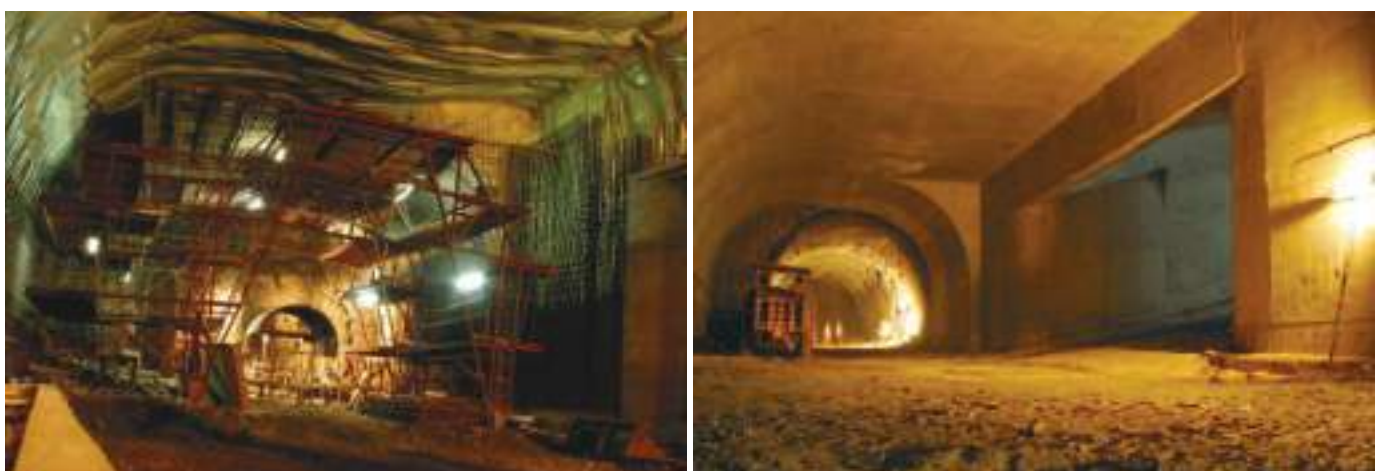
Fig. 05 Vista geral da gare de estacionamento para pesados e da galeria de ligação para veículos na fase de impermeabilização e após a conclusão do revestimento secundário. Overview of the heavy vehicles' parking layby and connection gallery for vehicles in the waterproofing stage and after the conclusion of the secondary lining.
