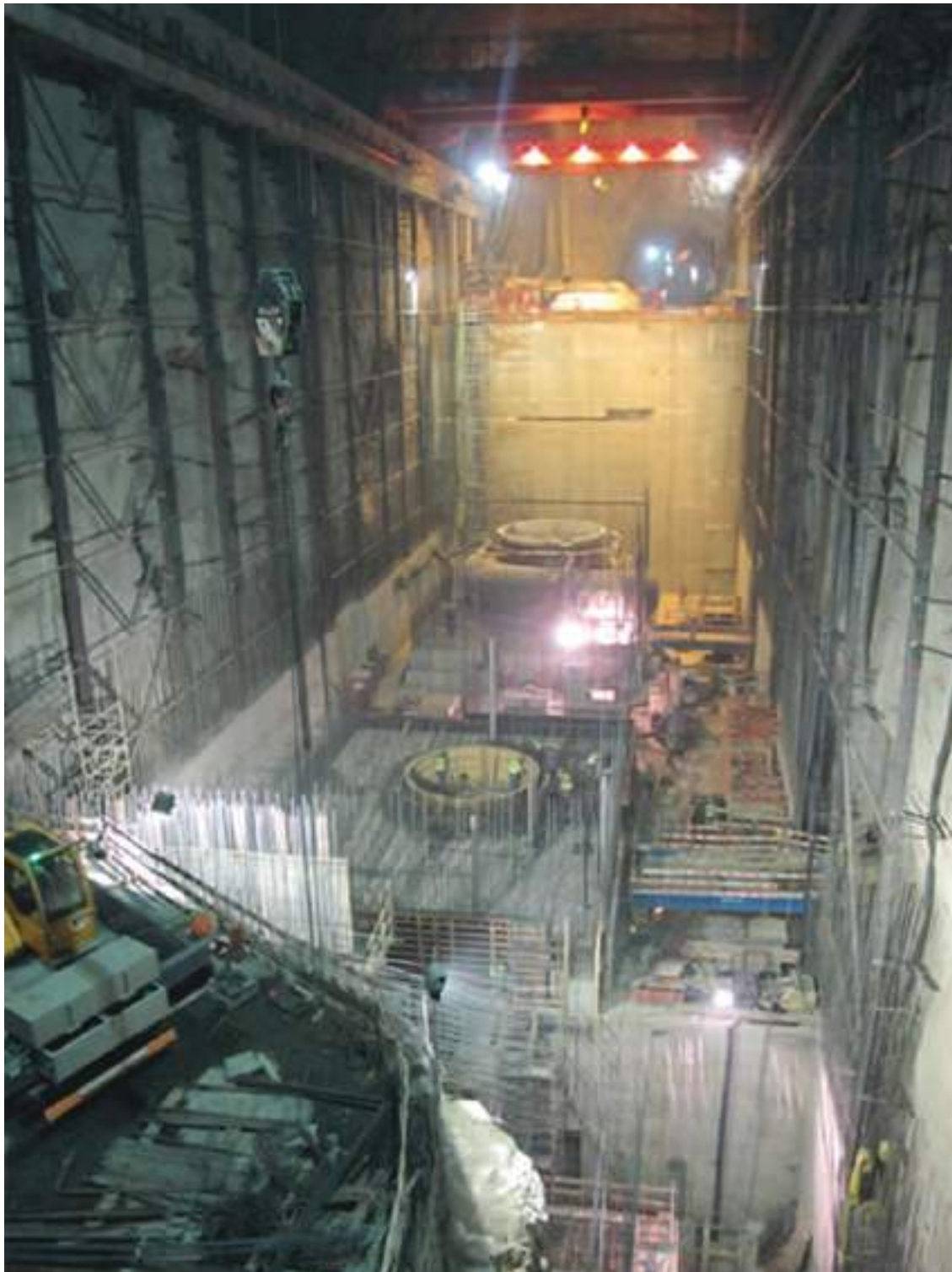
Fig. 08 Caverna da central. Powerhouse cavern.
