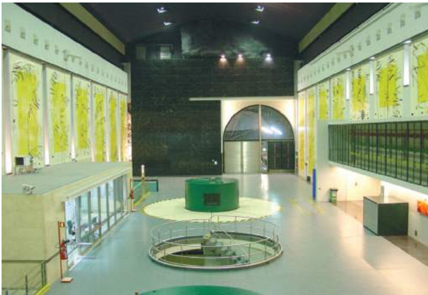
Fig. 06 Central de Frades. Frades powerhouse.
