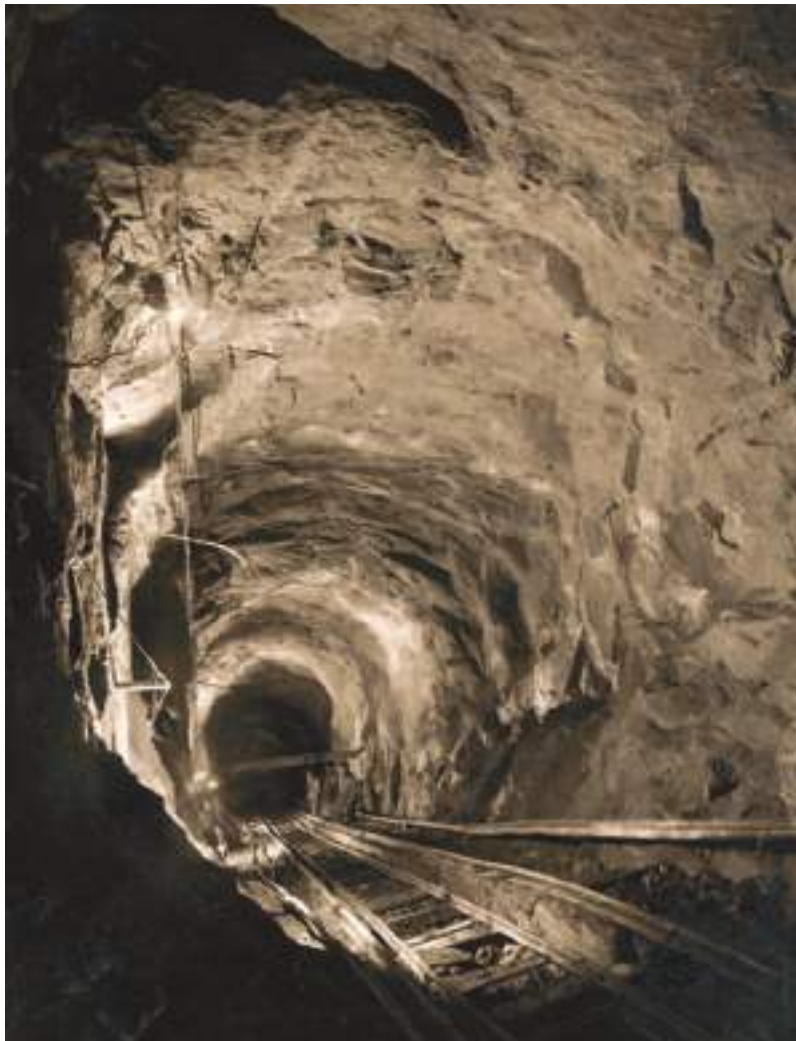
Fig. 03 Túnel em carga na fase de construção. Headrace tunnel during the construction phase.
