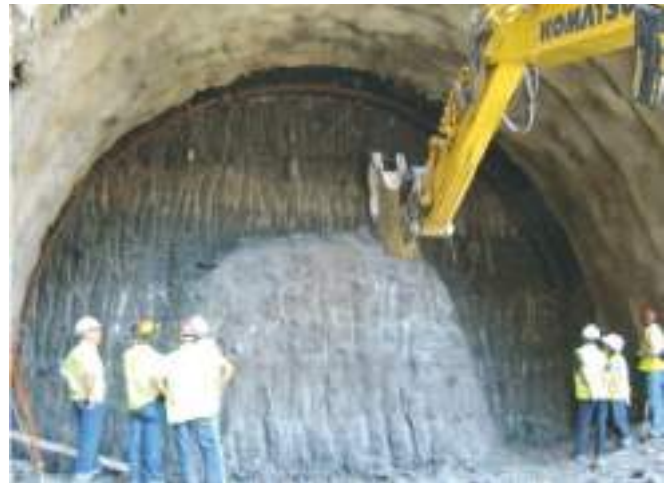
Fig. 10 Observação da frente de escavação do túnel mineiro mais profundo, em sede de ATO. Inspection of the face in the deeper tunnel.
