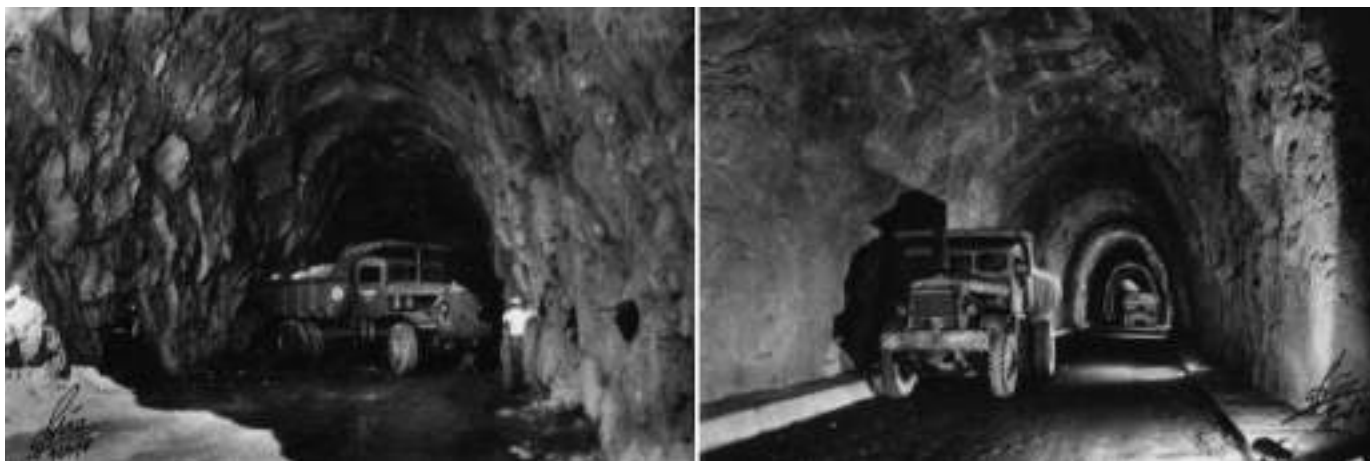
Fig. 06 Túneis de acesso na fase da construção. Access tunnels during the construction phase.
