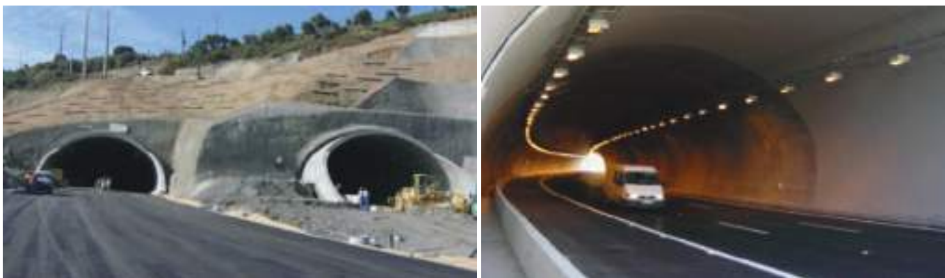
Fig. 06 Vista geral do emboquilhamento Norte e aspeto final do interior da galeria direita. Northern portal overview and final view of the right gallery interior.
