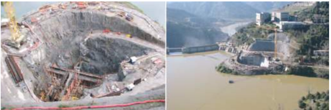
Fig. 04 Tomada de água e ensecadeira de montante. Upstream water intake and cofferdam.
