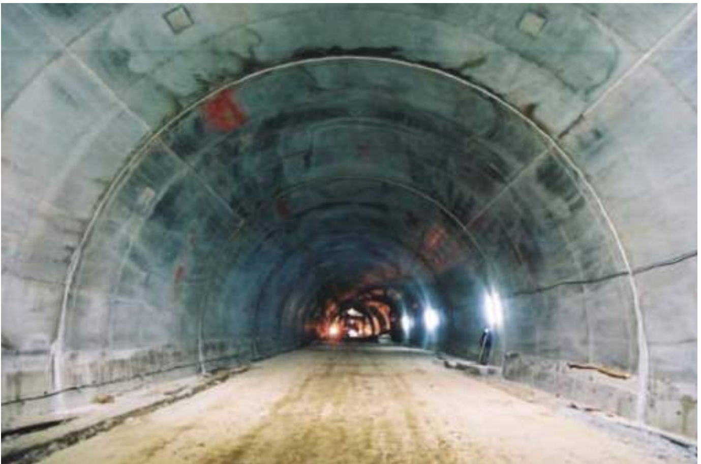
Fig. 08 Sistema de impermeabilização e revestimento definitivo do Túnel da Portela. Waterproofing and final lining system of Portela tunnel.
