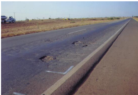
Danificação num pavimento convencional
