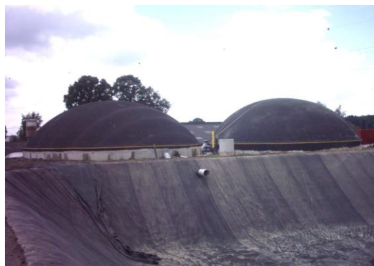
Digestores anaeróbicos com lagoa de resíduos
